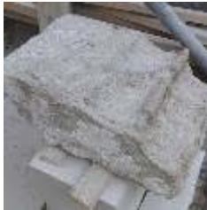
Stark verwitterter Stein von 1882 von der Einfassung der Tür zur Sakristei
